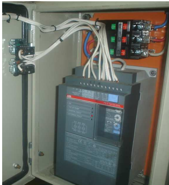
Figura 4.15 Arrancador en falla
