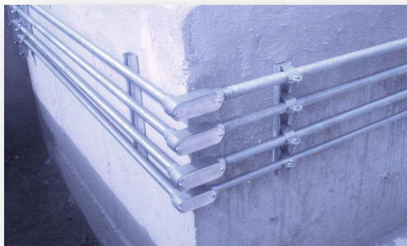
Gráfico 7.41 Tubería Rígida y Conduletas
