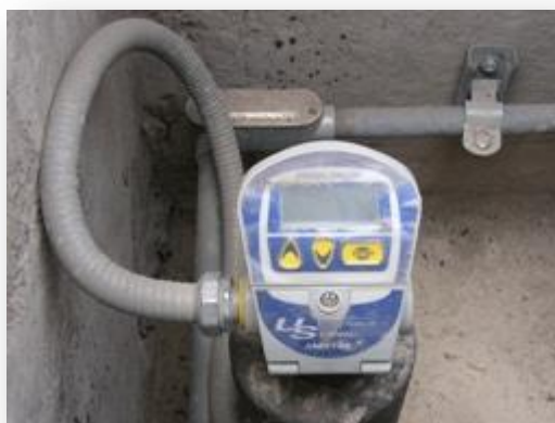
Gráfico 7.50 Sensor de Nivel Instalado
