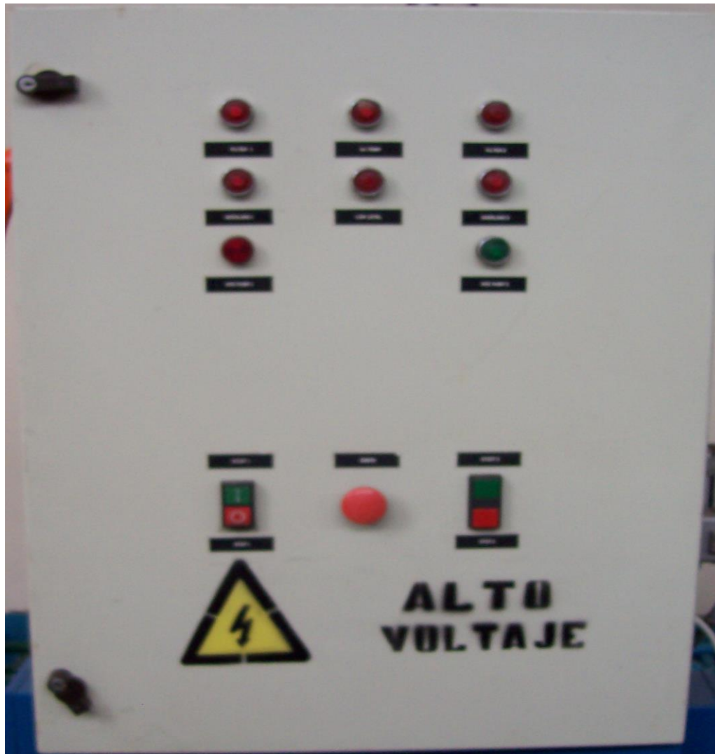
Fig. 3.11 Descripción del panel de control
