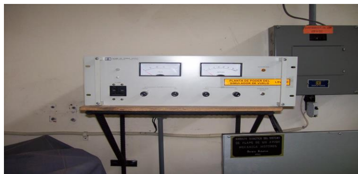
Fig. 4.1 Panel de potencia eléctrico
