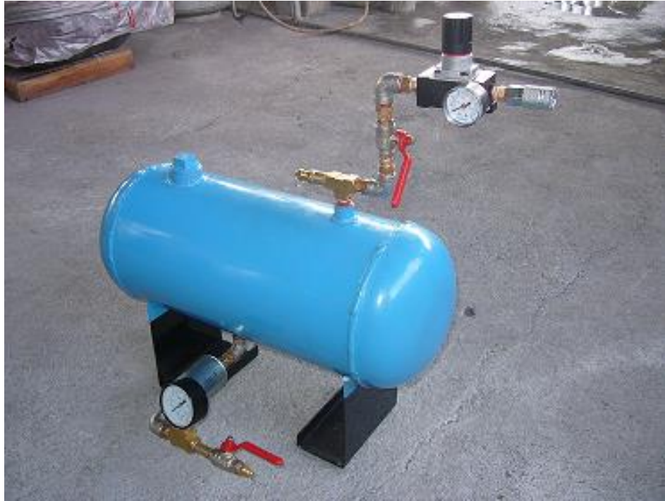
Figura 4.8. Sistema Neumático instalado en el tanque.
