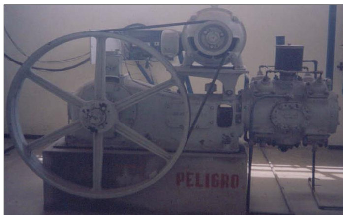
Figura 4.17 Compresor del antiguo sistema neumático.
