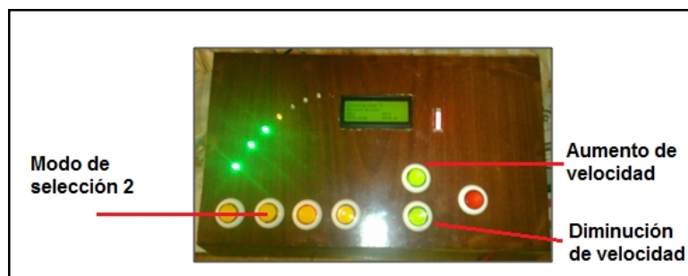
Figura. 6. 10 Tablero de control modo de selección 2
