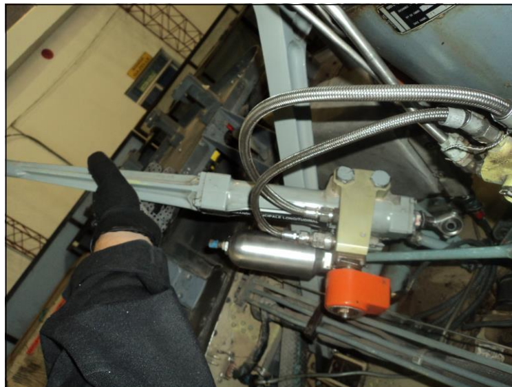
Figura 36 Instalación de Servo mando
