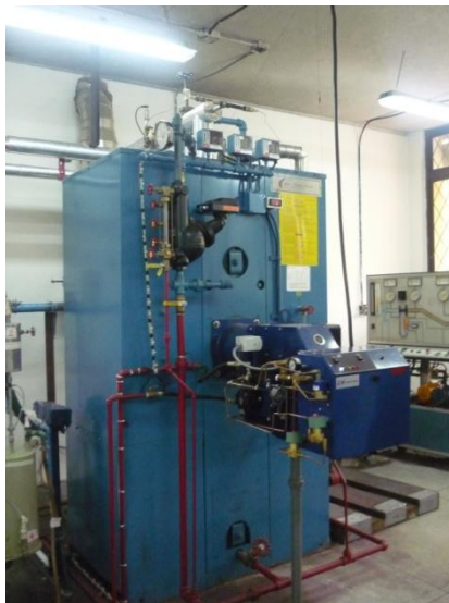
Figura 3.7 Caldero de Vapor con la bancada libre
