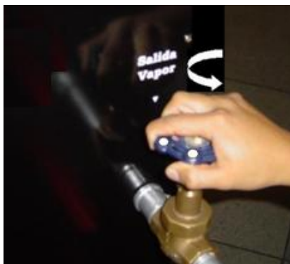
Figura 3.15 Apertura de la válvula para el flujo de vapor
