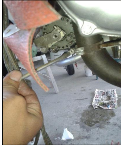
Figura 40. Instalación del gobernador
