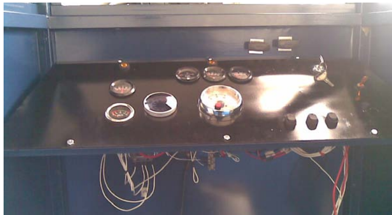
Figura 3. 7 Tablero de instrumentos y ruteado de cables
