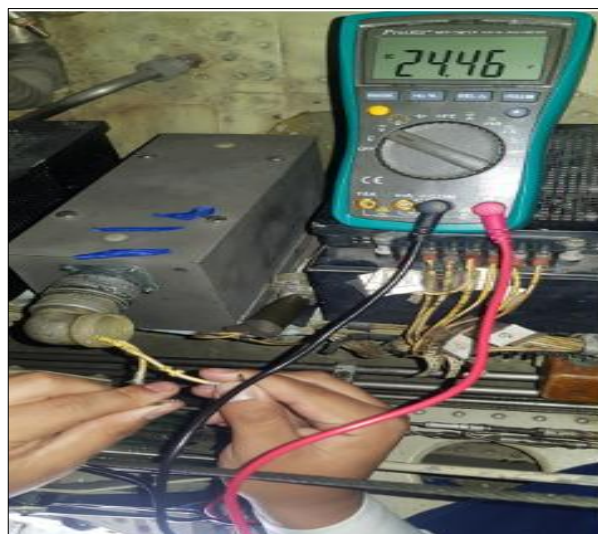
Figura 32 Carga de la batería
