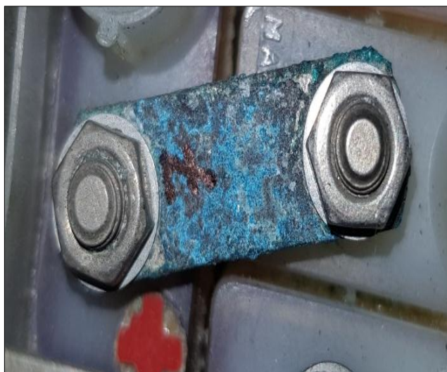
Figura 20 Enlace con presencia de corrosión
