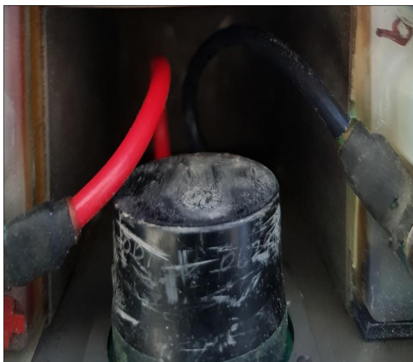
Figura 21 Conector eléctrico con suciedad
