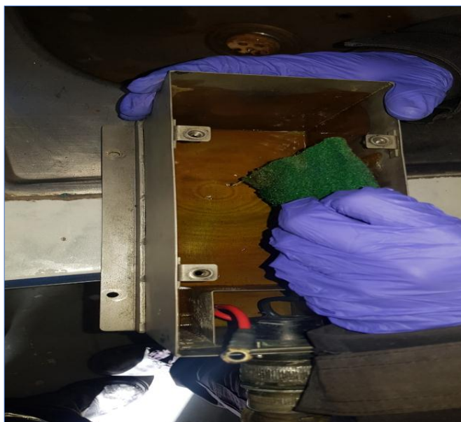
Figura 25 Presencia de fuga de electrolito en la caja de la batería
