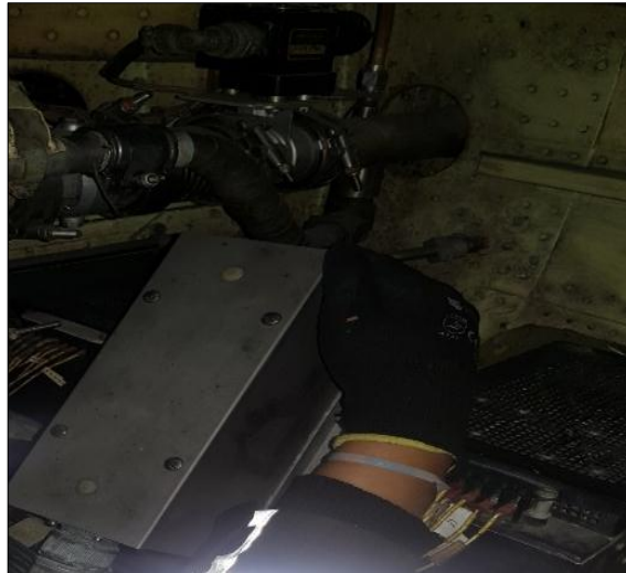
Figura 18 Desprendimiento de la batería de sus clavijas
