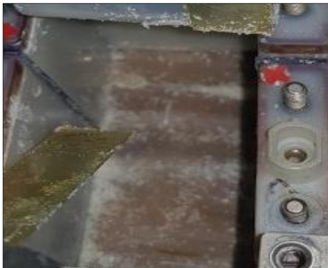
Figura 24 Presencia de sal en la caja de la batería
