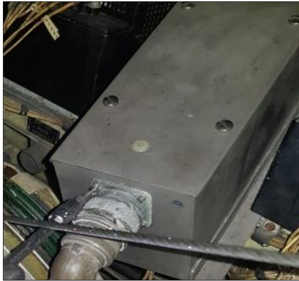
Figura 33 Batería colocada en su lugar
