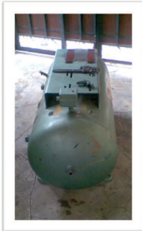
Foto 3.6 Reservorio del compresor
