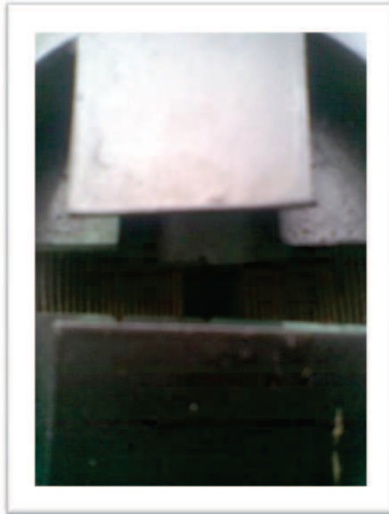
Foto 3.40 Filtro del compresor habilitado
