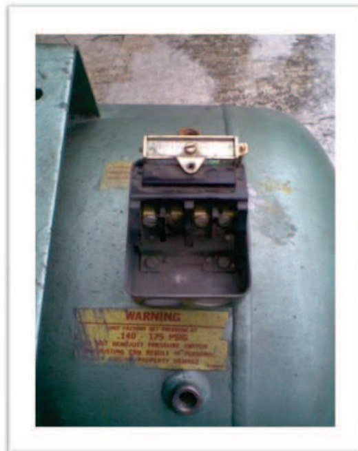
Foto 3.7 Presóstato del compresor
