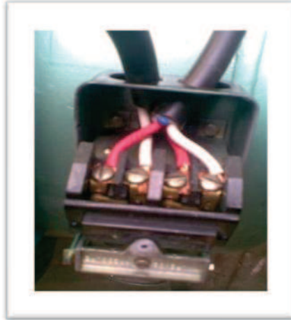
Foto 3.31 Instalación eléctrica en el presostato
