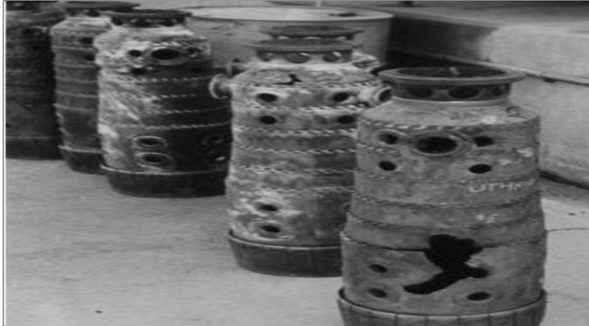
Figura 2.17 Rajaduras en la cámara de combustión
