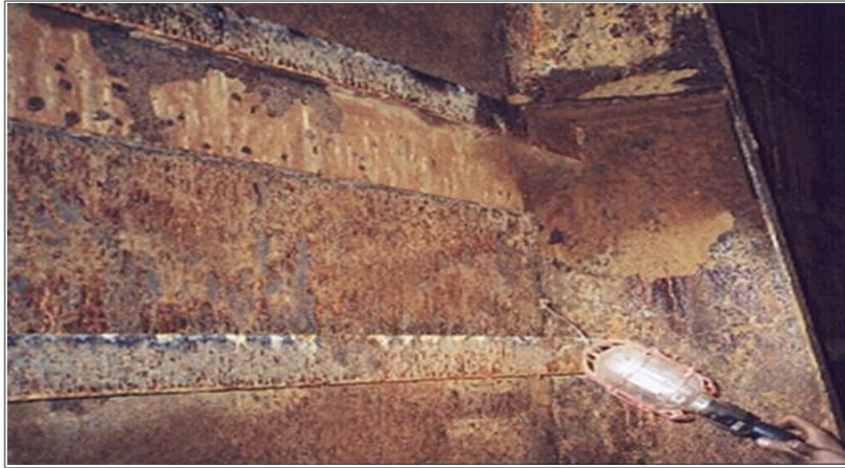
Figura 2.29 Falta de adherencia (Disbonds)
