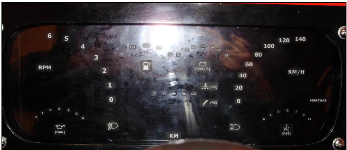
Figura 3.14 Tablero de instrumentos instalado
