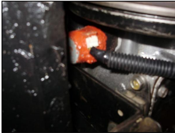
Figura 3.8 Sensor de velocidad instalado
