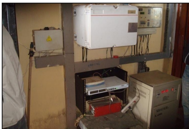
Figura 4. 28 Caseta de alimentación en Pilisurco (interior)
