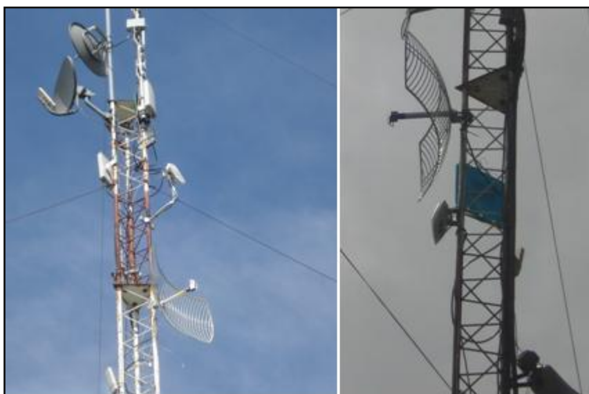
Figura 4. 33 Instalación de Antena Directiva de grilla
