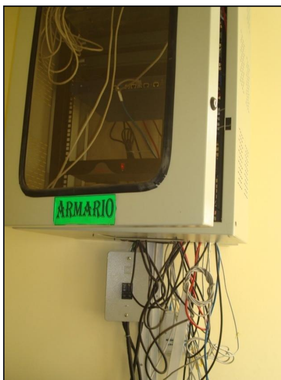
Figura 4. 30 Suministro de Energía en Brigada Patria
