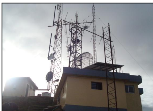
Figura 4. 27 Caseta de Alimentación en Pilisurco
