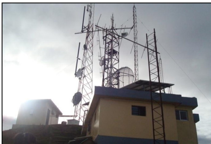
Figura 4. 6 Caseta de Alimentación Cerro Pilisurco
