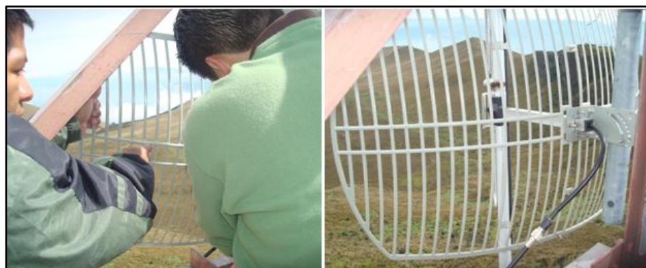
Figura 4. 36 Instalación de Antena Directiva de grilla Cerro Pilisurco
