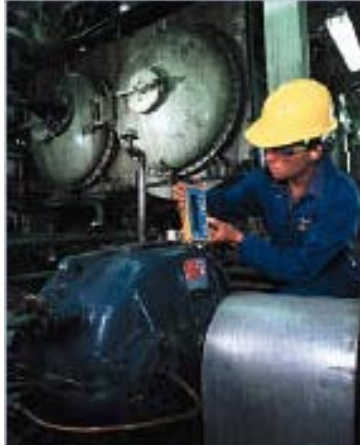
Figura 2.13 - Control de mantenimiento de máquinas industriales.
