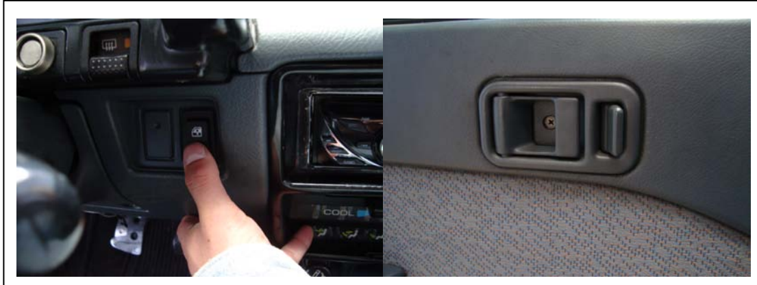
Figura 5.4 - Prueba de abertura del seguro de las puertas.
