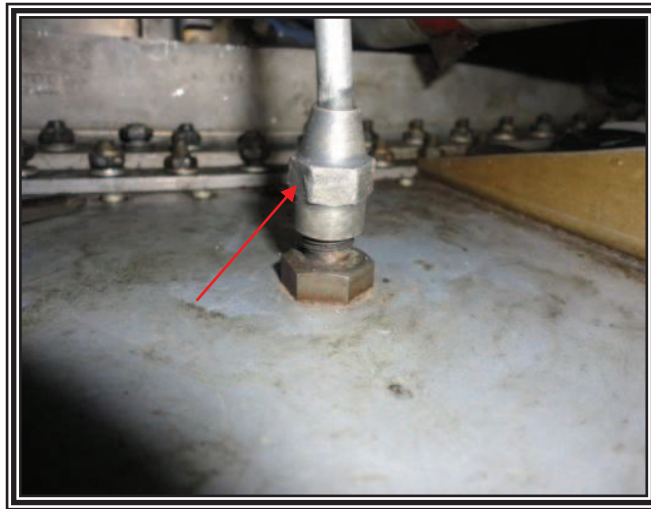
Figura 3.43 Cañería de ventilación
