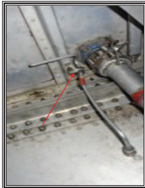
Figura 3.40 cañerías de ventilación de combustible
