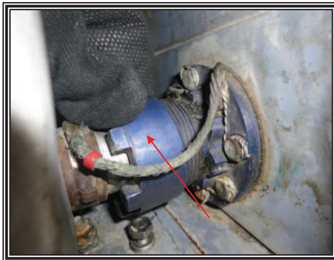
Figura 3.42 Cañería de combustible
