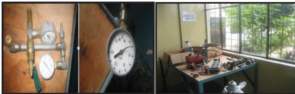
Figura 3.2 Manómetros de presión inoperable
