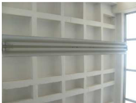
Figura 3.2. Taller de pintura sin conexiones eléctricas
