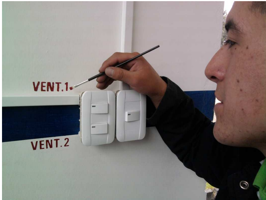
Figura 4.8. Identificación de los interruptores.
