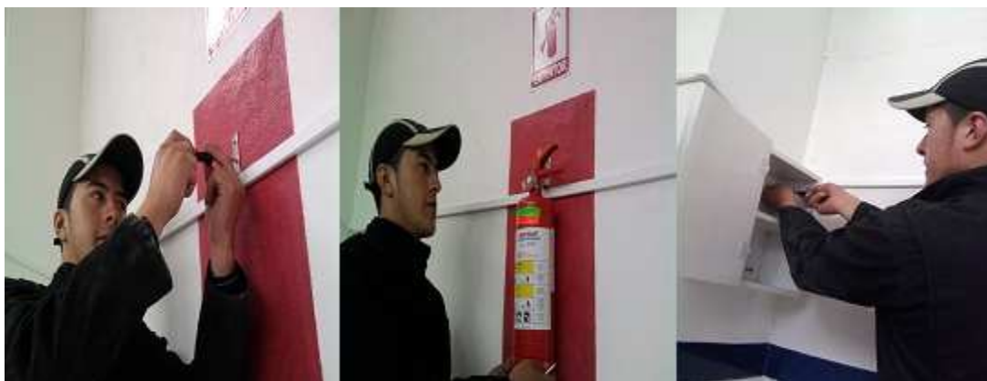
Figura 4.11. Ubicación del extintor y botiquín.
