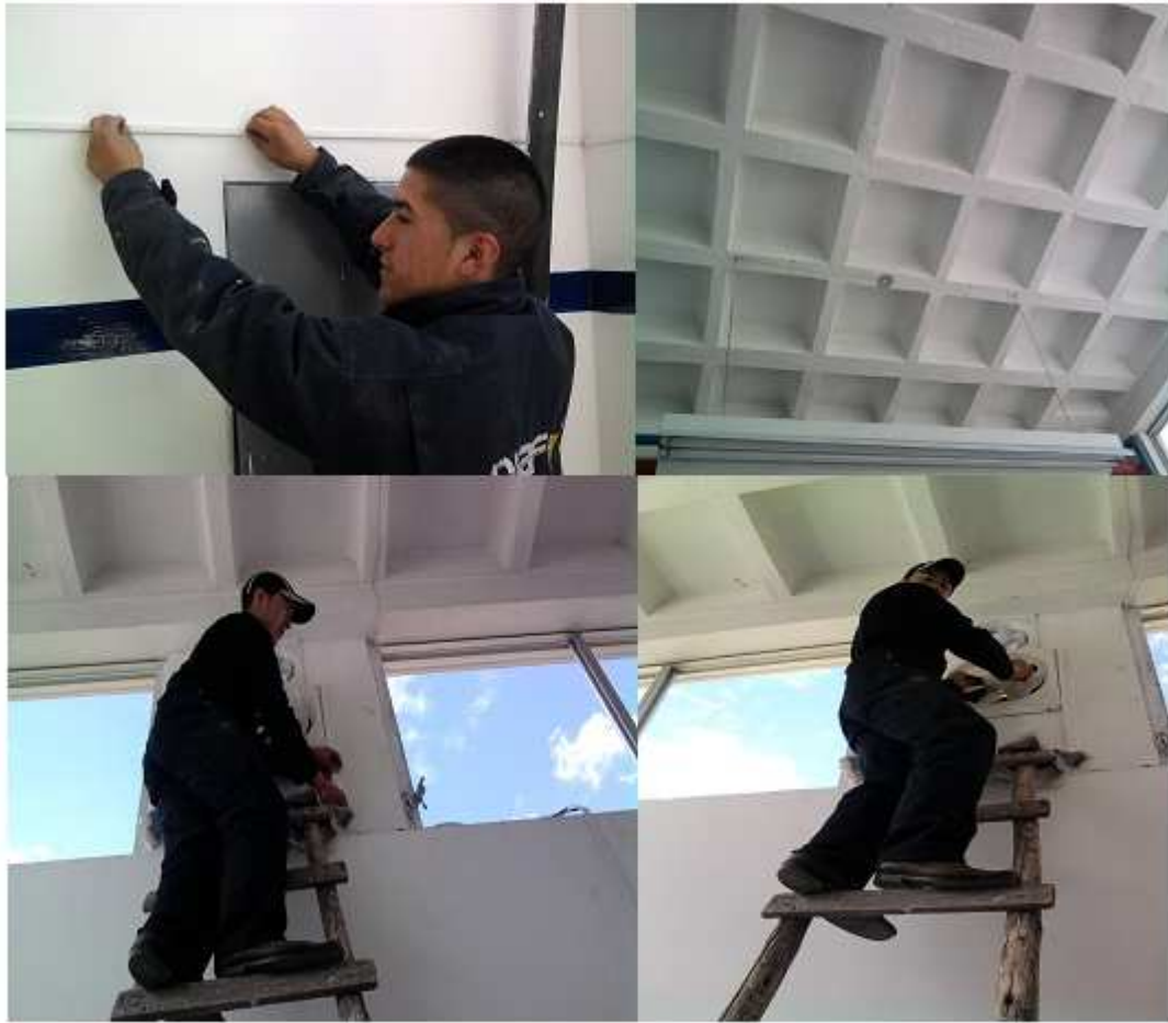
Figura 4.9. Instalación y conexión de un interruptor doble para los ventiladores de extracción.
