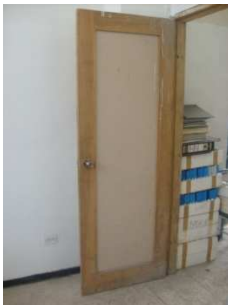
Figura 3.4. Inadecuada ubicación de la puerta de acceso.
