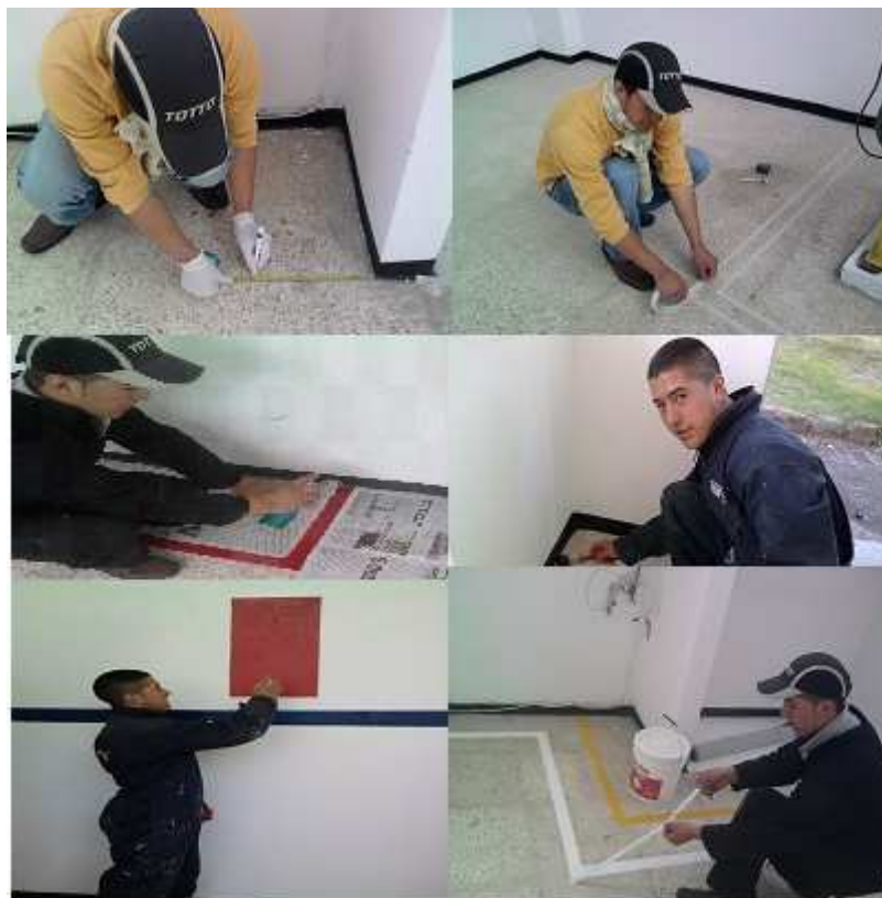
Figura 4.6. Señalización de líneas de tránsito y de seguridad.
