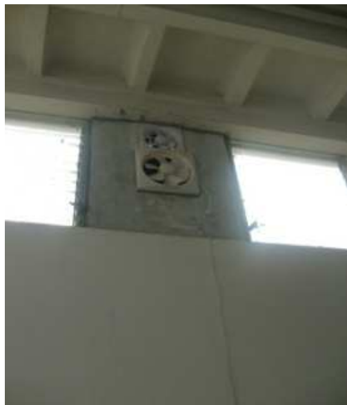
Figura 3.3. Sistema de ventilación del taller inoperativo
