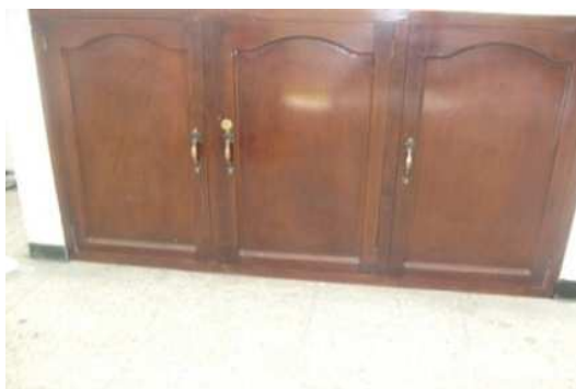
Figura 3. 5. Closet de almacenamiento deteriorado.
