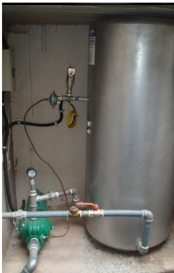
Figura 4. 57 Sistema de Bombeo
