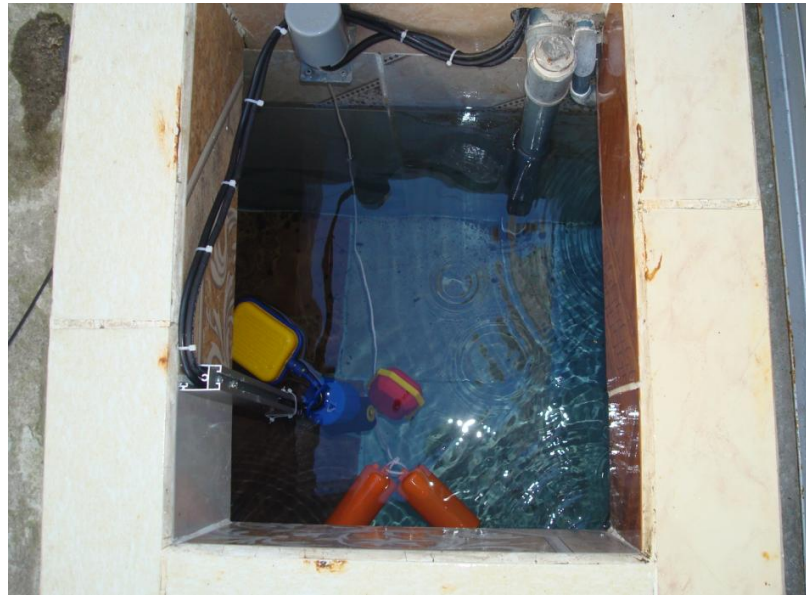
Figura 3. 31 Sistema real de Cisterna con Boyas de Nivel
