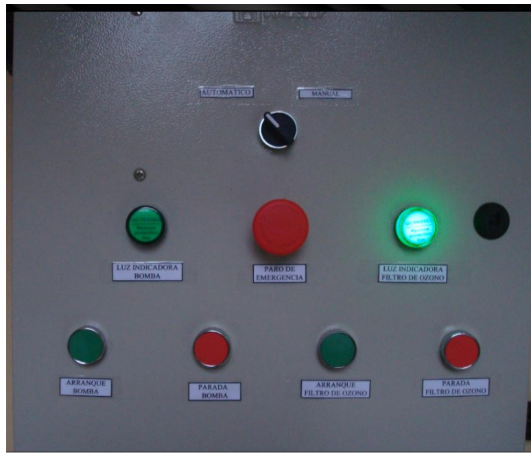
Figura 4. 58 Tablero de Control
