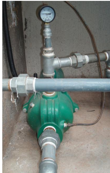
Figura 4. 43 Bomba de Agua MYERS Instalada
