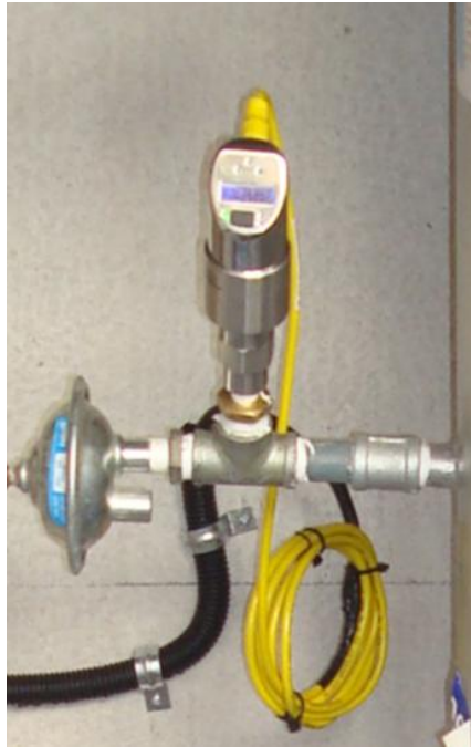
Figura 4. 1 Sensor de Presión Instalado
