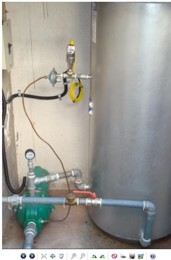
Figura 3. 29 Sistema real de Tanque y Sensor Instalado
