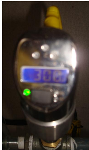
Figura 4. 41 Sensor de Presión Operando
