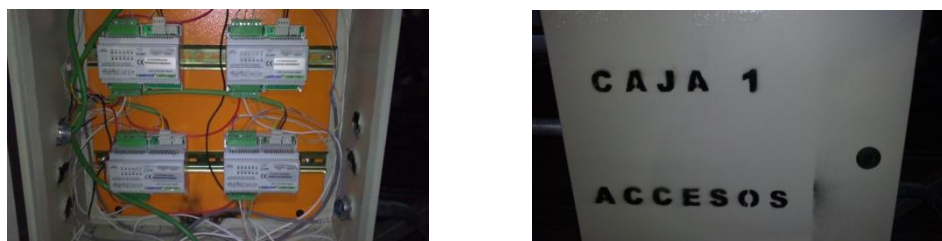
Figura. 5.6. Equipos instalados dentro de cajas Inmoticas
