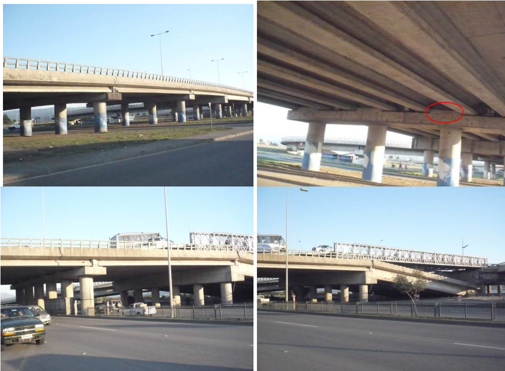
Figura 20 Falla de un tramo del Puente Llacolen.
