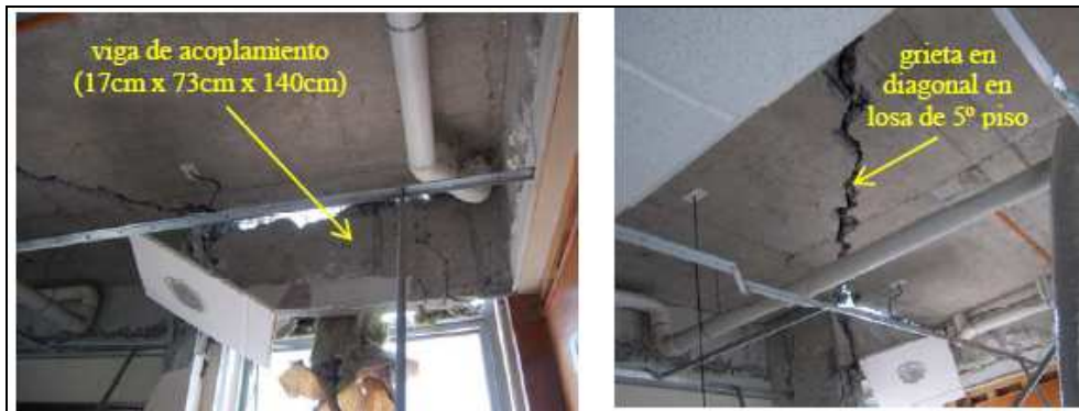
Figura 32 Daño en dintel y losa. Almazán (2010).
