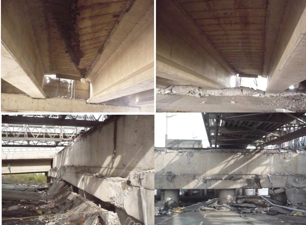
Figura 21 Daño en tablero y apoyo de Puente Llacolen.
