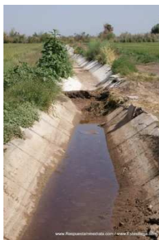
Figura 65 Agrietamientos en canales (www.estesillega.com)
