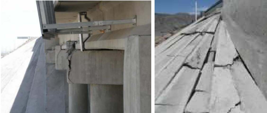
Figura 67 Daños en puente carretero (fotos cortesía de Majid Sarraf)
