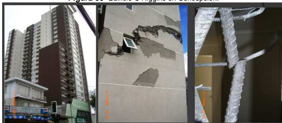
Figura 36 Falla por corte cizalle en edificio de Concepción.
