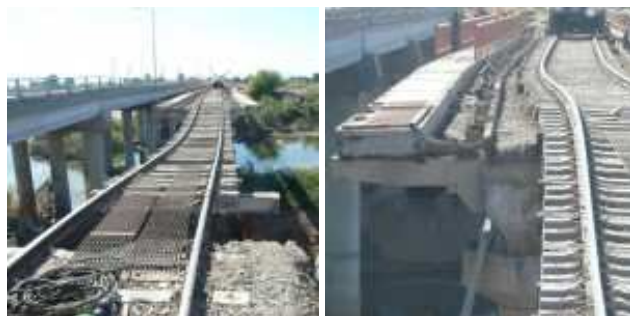
Figura 66 Daños en puente ferroviario (fotos cortesía de Majid Sarraf)
