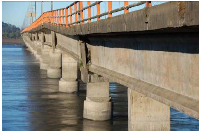
Figura 26 Asentamiento en un apoyo por efecto de la socavación en el Puente Juan Pablo II.
