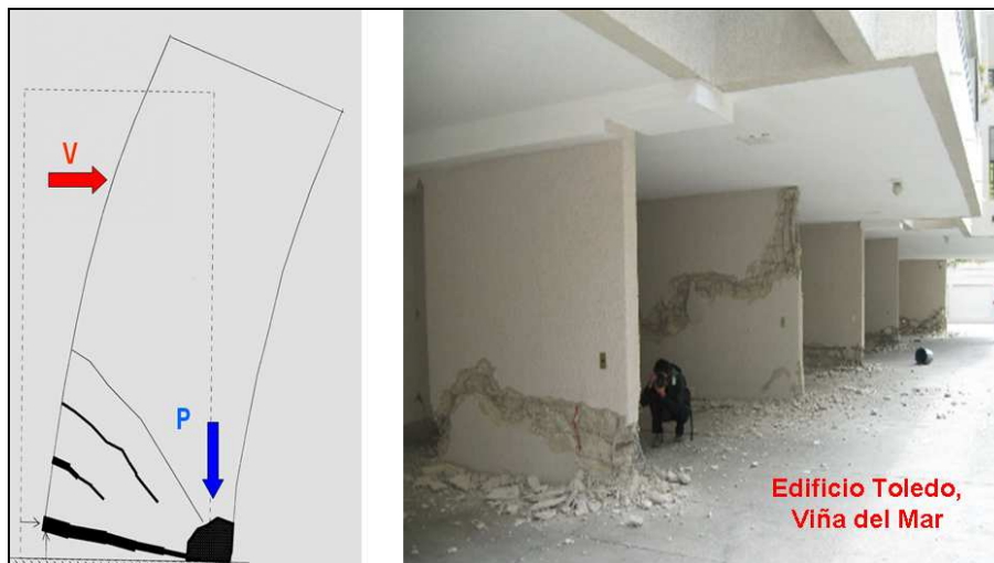
Figura 33 Falla por flexión en muros. San Bartolomé et al. (2010).
