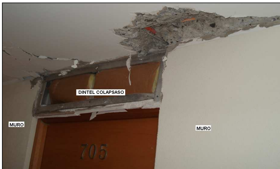
Figura 31 Colapso de un dintel y daño en la losa. Sarrazín (2010)
