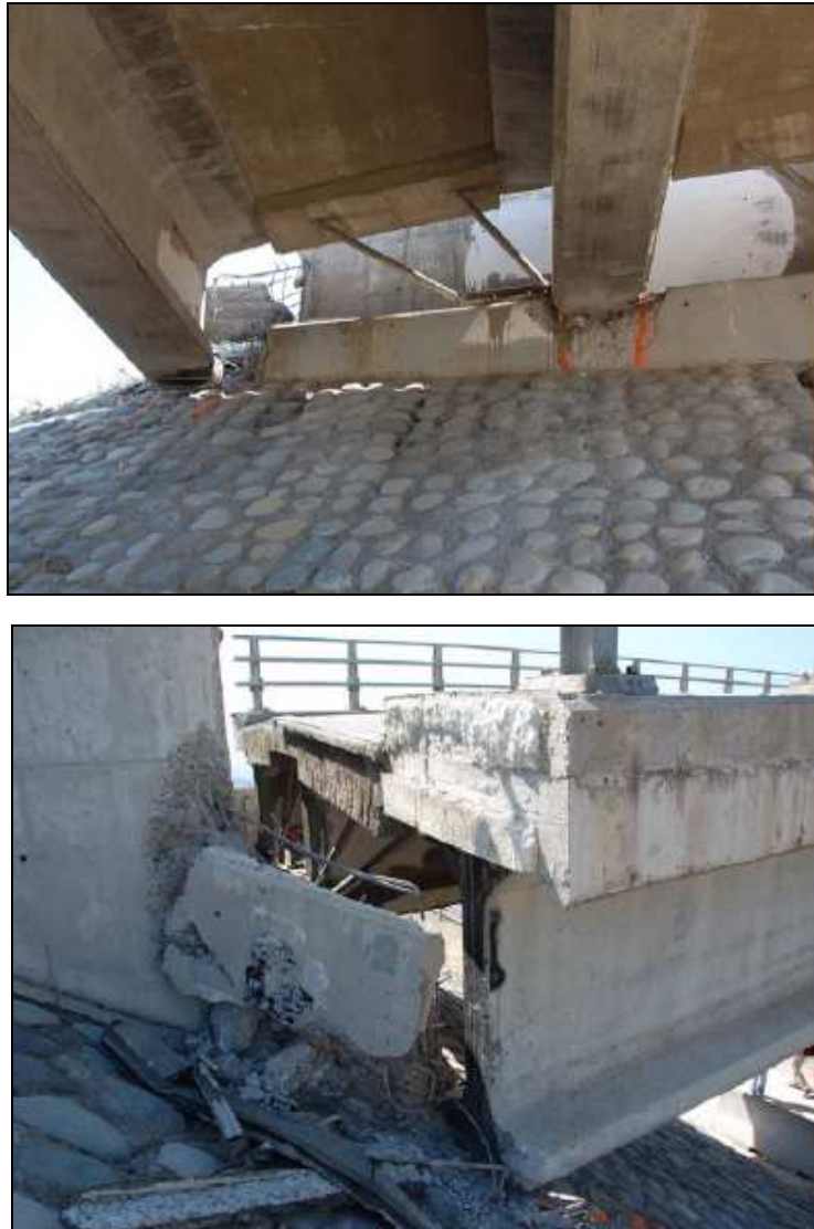
Figura 22 Falla de elementos de anclaje vertical y tope sísmico del Puente las Mercedes. Kawashima et al. (2010)
