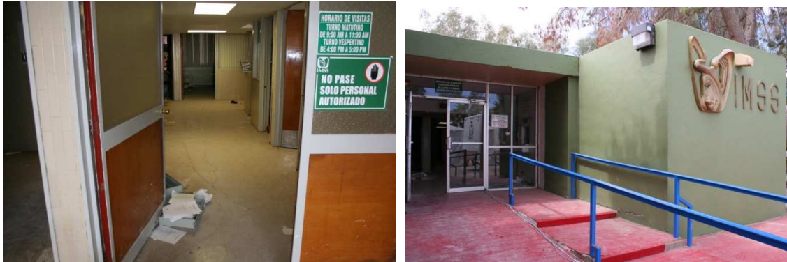
Figura 60 Clínica rural del IMSS en Ejido Durango que experimentó daños importantes por la licuación del suelo.
