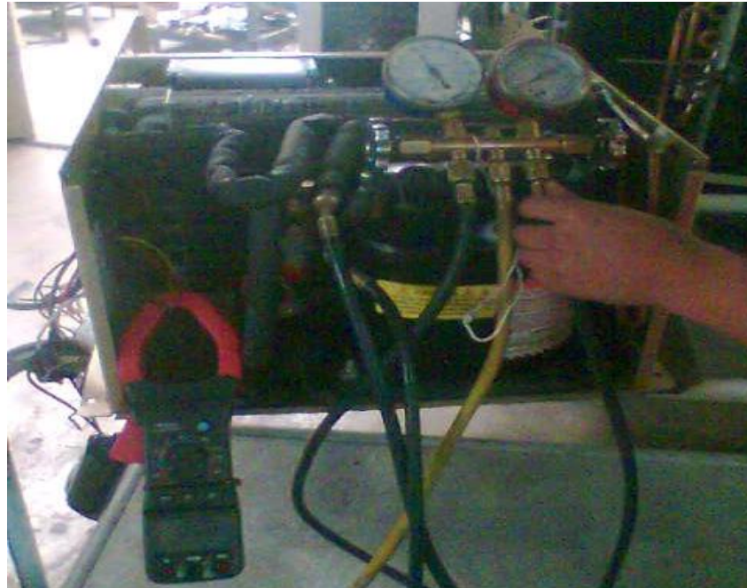
FIGURA 3.14 Carga del refrigerante
