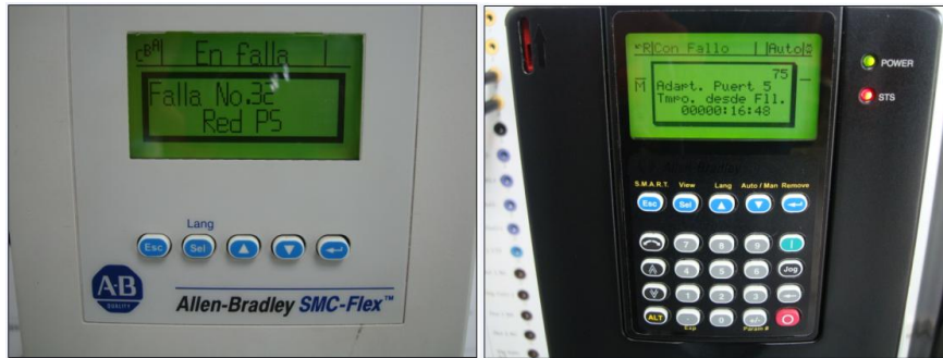
FIG. 3.3: Fallos de los equipos conectados en DeviceNet
