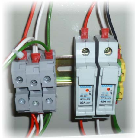
Figura 6.3. Porta fusibles y borneras colocados en el Panel
