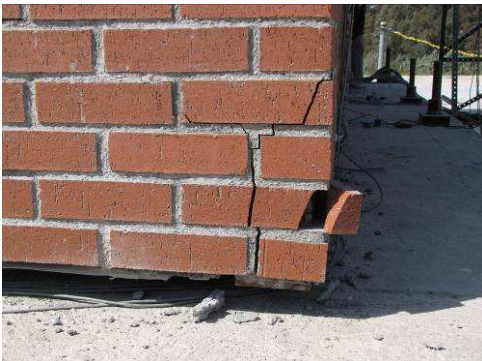
Figura 18 Agrietamiento de fachada en la esquina sureste (1.50 Tarzana)
