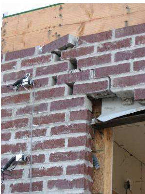
Figura 14 Colapso Incipiente de dintel en la esquina noreste (segundo 2.0 Sylmar, >MCE)
