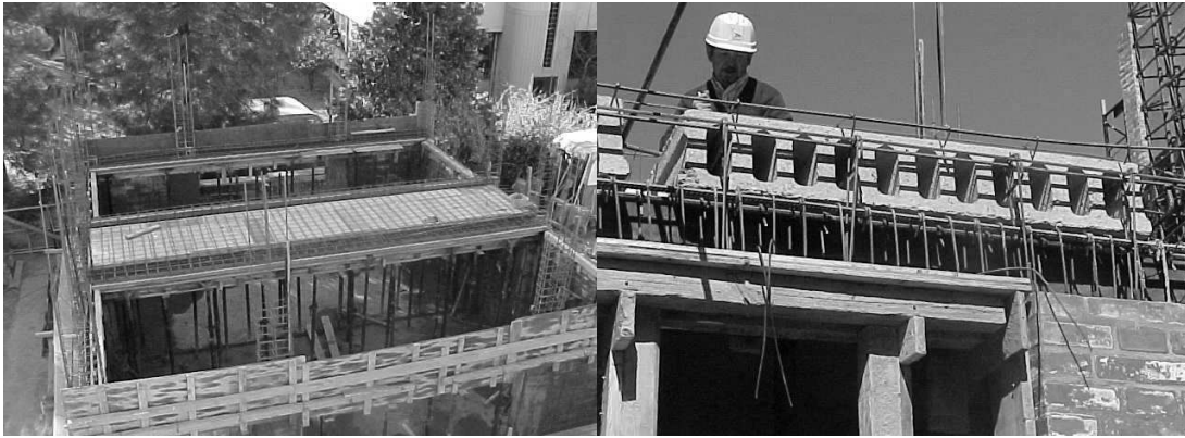
Figura 21 Trabajos de mampostería, losa del 1º nivel y estructura vertical del edificio aislado
