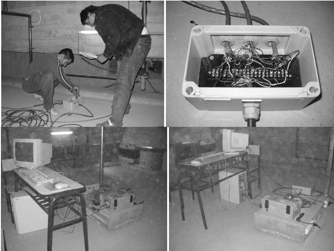
Figura 47 Tendido de cables y conexiones sensores externos. Central de adquisición de datos
