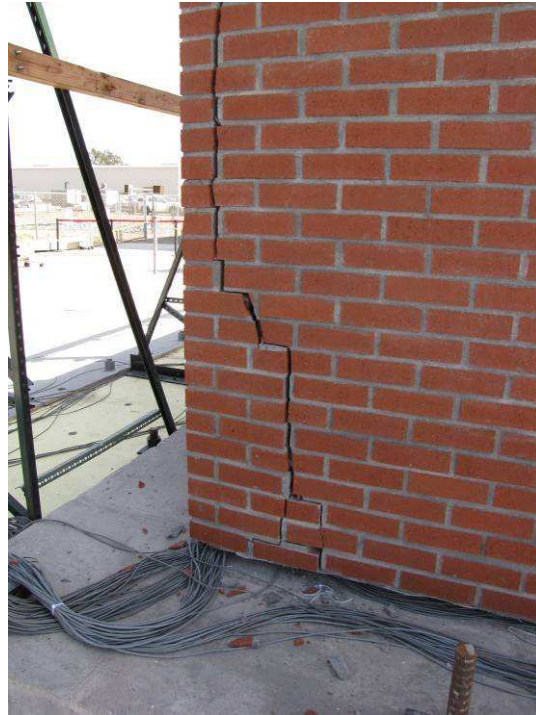
Figura 17 Agrietamiento de fachada en la esquina noreste (1.50 Tarzana)
