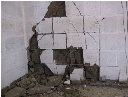
Figura 24 Daños a mampostería de concreto luego de la segunda corrida a 1.50 Tarzana
