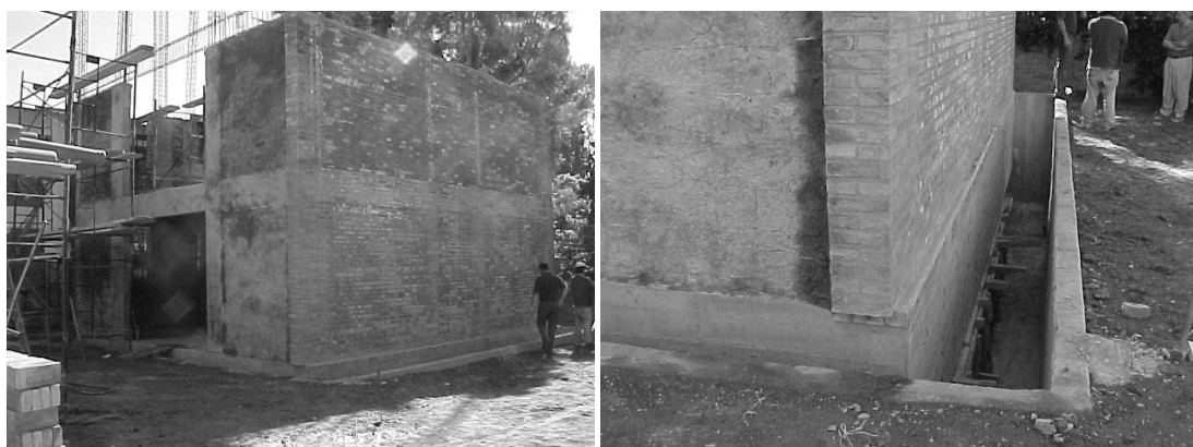
Figura 37 Edificio aislado en la etapa constructiva previa al montaje de los dispositivos de protección
