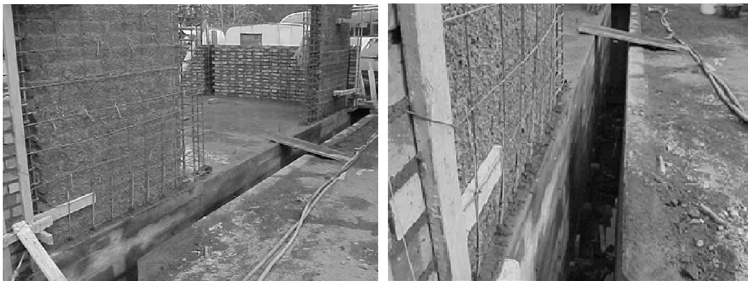
Figura 26 Muros de mampostería con ladrillos macizos. Armaduras dispuestas en los paramentos exteriores del muro
