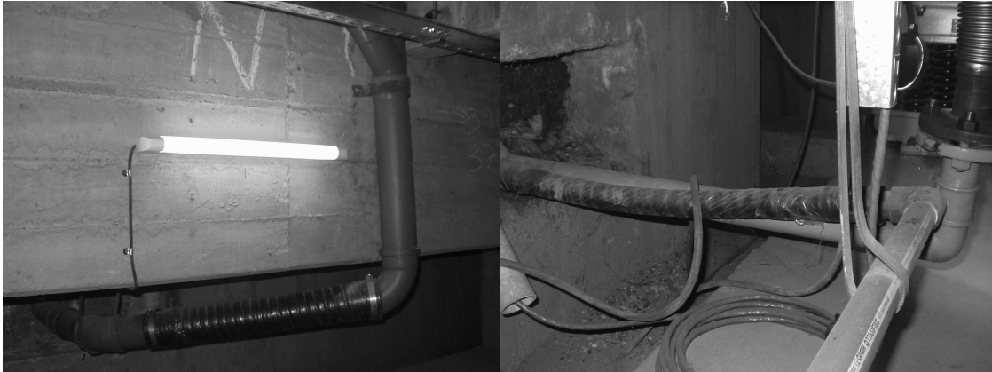
Figura 28 Conexiones flexibles del suministro de agua y de los desagües primarios
