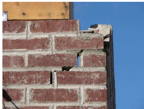
Figura 7 Agrietamiento diagonal en la parte superior del segmento por la puerta, lado sur (primero 2.0 Sylmar, >MCE)
