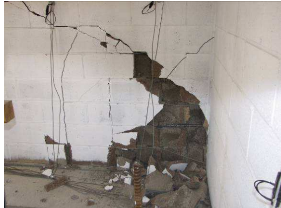
Figura 23 Daños a la mampostería de concreto luego de la segunda corrida a 1.50 Tarzana
