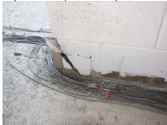
Figura 19 Falla local de mampostería de concreto en el borde del segmento largo en el lado sur, debido a deslizamiento en el plano (1.50 Tarzana)
