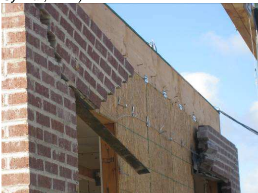
Figura 6 La fachada se cae, parte superior del lado este (primero 2.0 Sylmar, >MCE)
