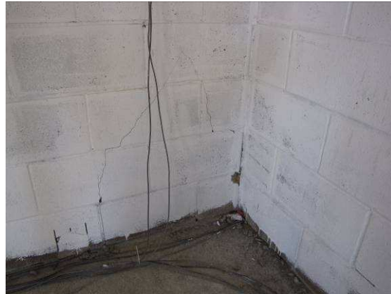
Figura 21 Agrietamiento del muro de mampostería de concreto en la esquina sureste por flexión fuera de plano de franjas horizontales de muro, mientras la estructura se deslizaba en sentido este-oeste (1.50 Tarzana)
