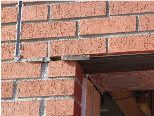
Figura 20 Desplazamiento relativo en junta de expansión en la fachada de mampostería de arcilla por la puerta en el lado sur (1.50 Tarzana)
