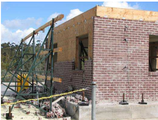
Figura 4 La fachada se cae, lado oeste (0.8 Sylmar, DBE)
