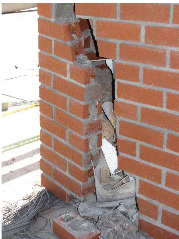
Figura 26 Detalle de daño a la esquina noreste luego de la segunda corrida a 1.50 Tarzana
