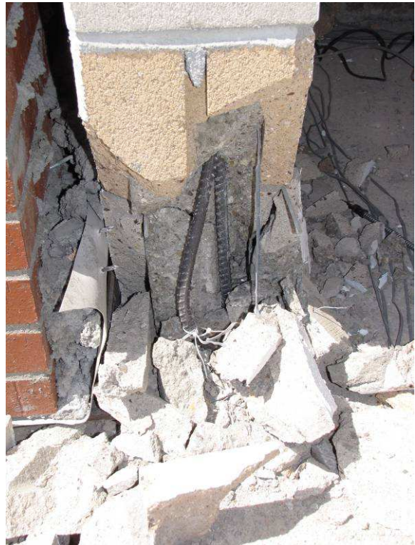
Figura 25 Pandeo inelástico de empalme en refuerzo vertical del lado sur luego de la segunda corrida a 1.50 Tarzana
