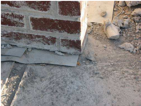
Figura 12 Deslizamiento de fachada en el plano, esquina noroeste (segundo 2.0 Sylmar, >MCE)
