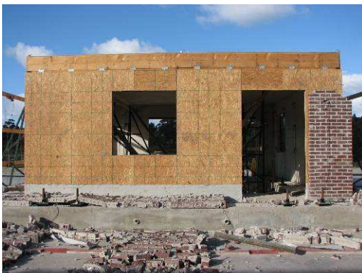
Figura 8 La fachada se cae del lado sur (segundo 2.0 Sylmar, >MCE)
