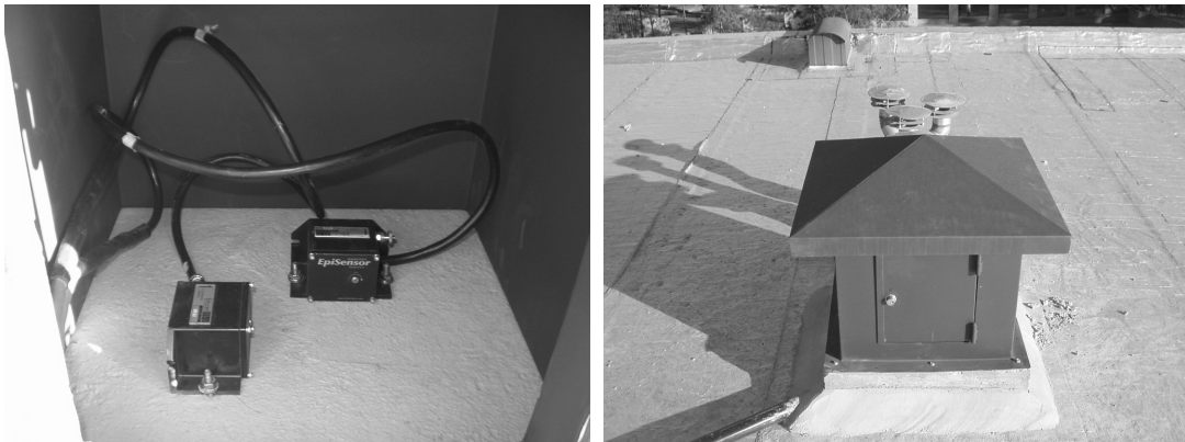
Figura 48 Coberturas metálicas de protección de los sensores externos.
