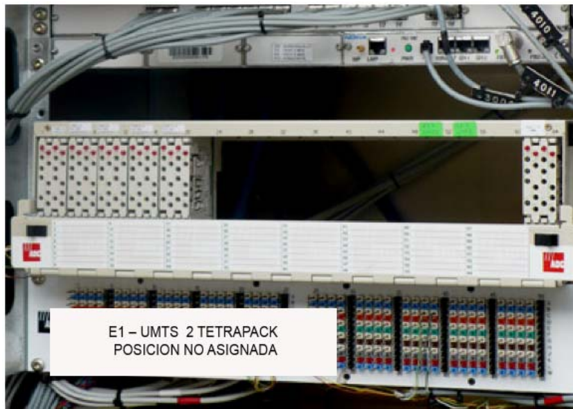
Ubicación del Tetrapack (E1's a ser Utilizados) en panel de Transmisión localizado en Power One / Nuss / Rack de 19 "
