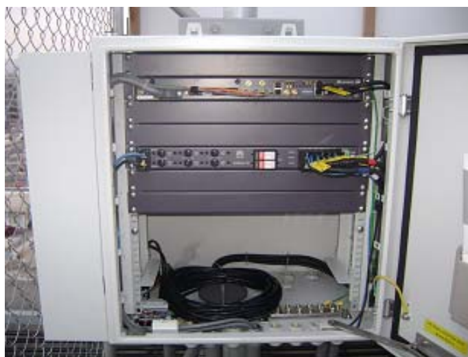
Figura. 5.20. Equipos instalados en OFB (outdoor)
