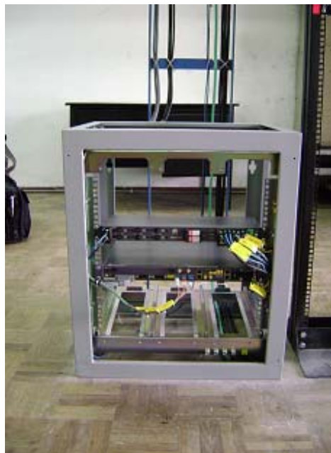
Figura. 5.19. Equipos instalados en un mini rack de 19-pulgadas (indoor)
