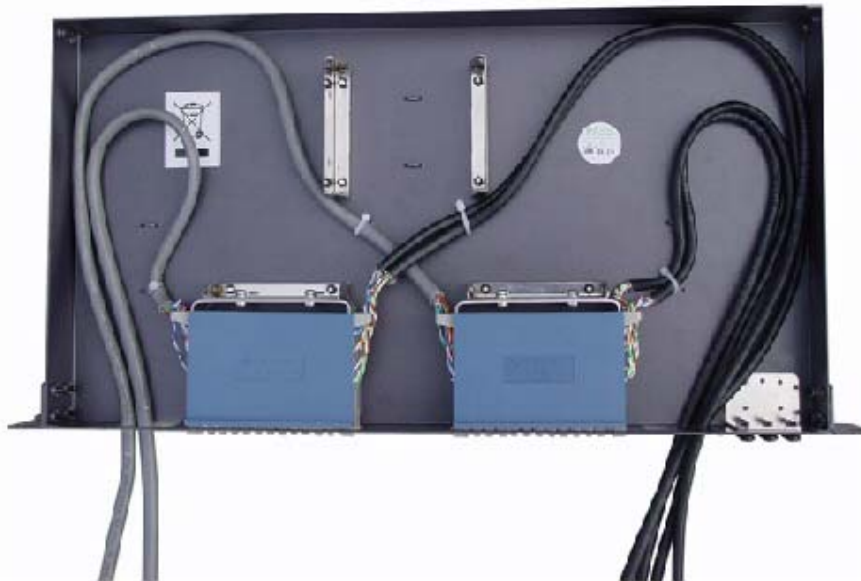
Figura. 5.78. Conexiones de la E1 cables de par trenzado en el SPBT
