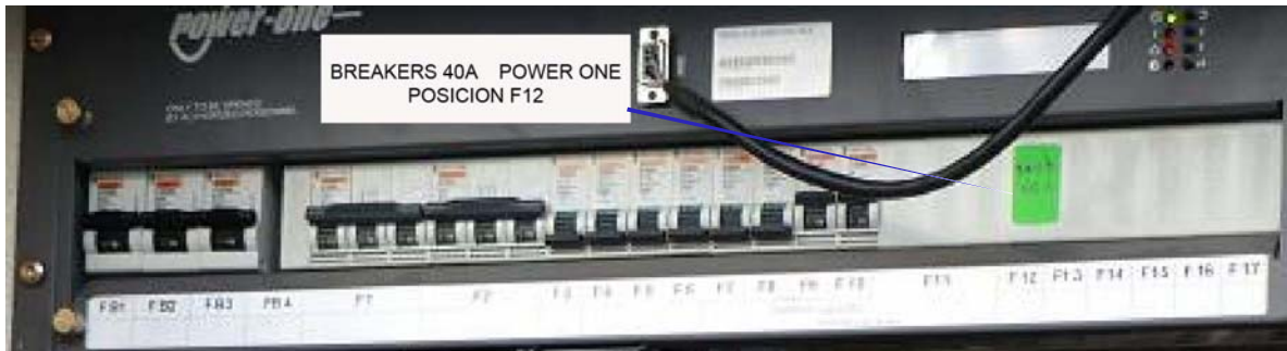
Figura. 4.13. Ubicación del Breaker a Utilizar en el panel de NUSS/ Power One / Power Plant
