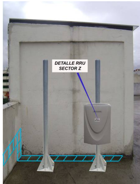
Figura. 4.7. Ubicación de la RRU del Sector Z en Polo (Torre/ Plataforma) o en Rack
