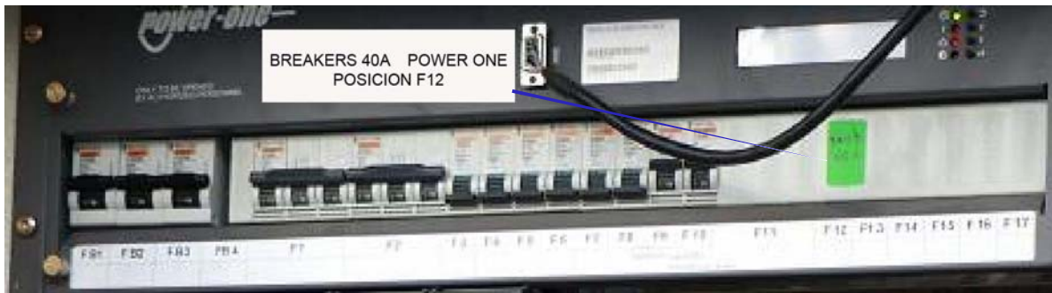
Figura. 5.49. Ubicación del breaker en la Power One
