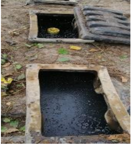
Figura 3. Aguas residuales Edificio Administrativo
