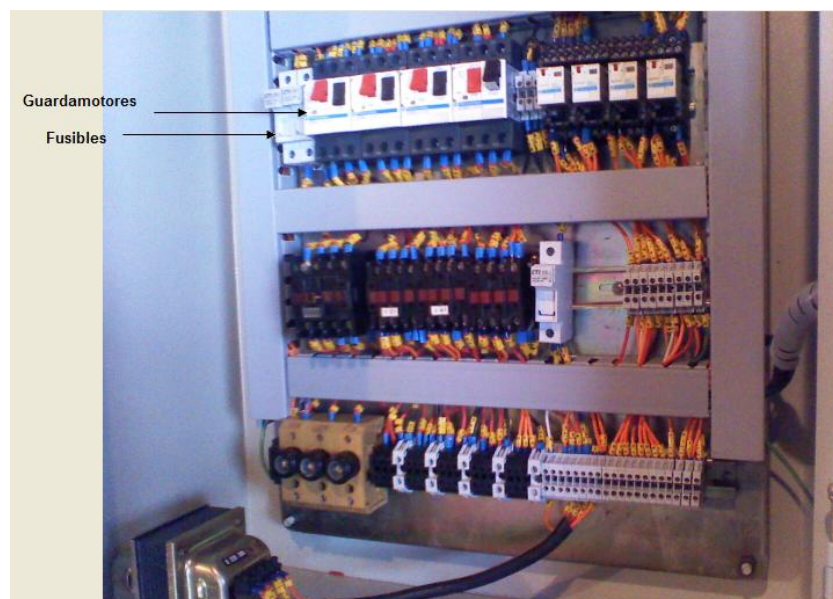
Figura 2.15 Guardamotores y Fusibles
