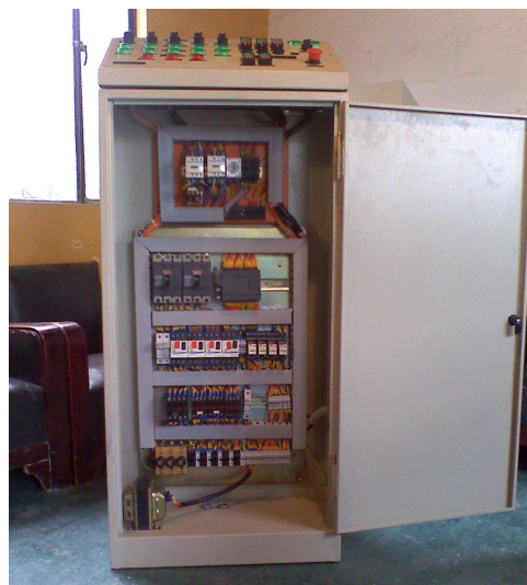
Figura 2.22 Tablero de Control de la VC1
