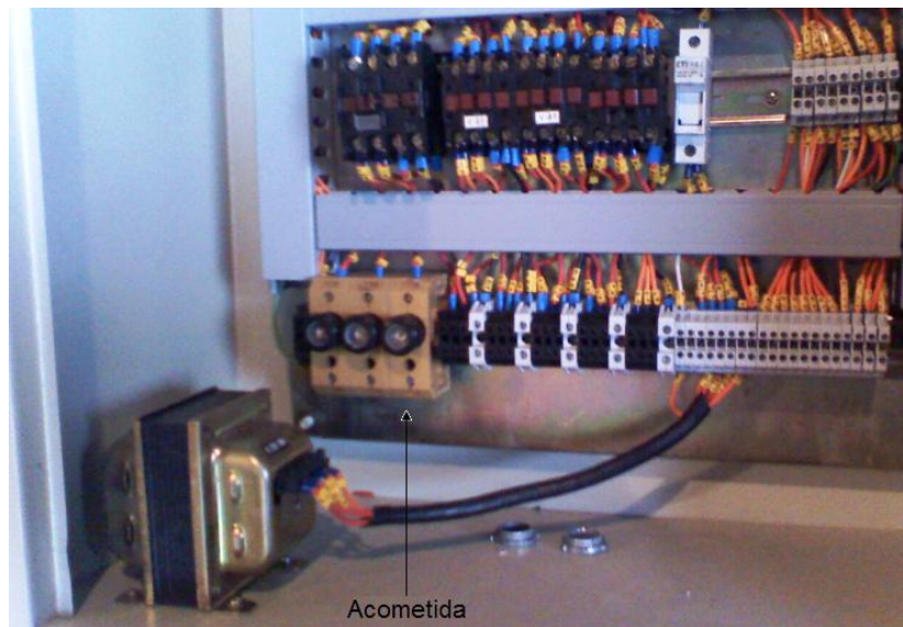
Figura 2.16 Acometida Trifásica del Tablero
