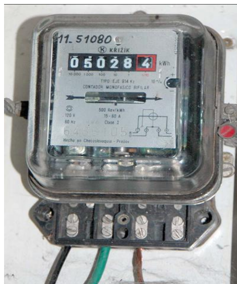
Figura 1.1 Medidor electromecánico de energía eléctrica.
