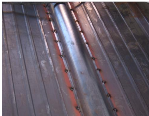
Figura 4.22.- pliegues en nuevo piso
