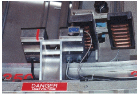
Fig. 1.95: "Caja de contactos" en un domo, suministran de alimentación a los dispositivos de la parte móvil del domo
