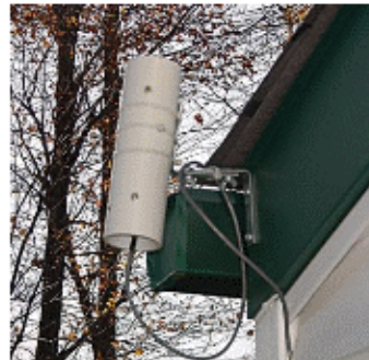
Fig. 1.83: Sensor de temperatura instalado en los exteriores de un observatorio
