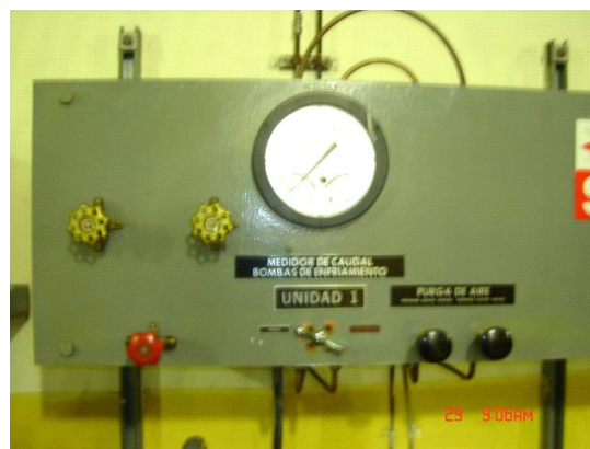
Figura 2.5. Antiguo medidor de Caudal de Bombas de Enfriamiento
