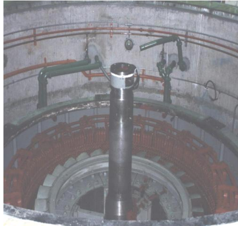
Figura 1.8. Devanados del estator del generador principal
