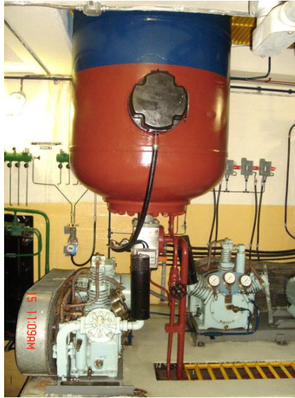
Figura 2.12. Tanque acumulador con su detector tipo flotador
