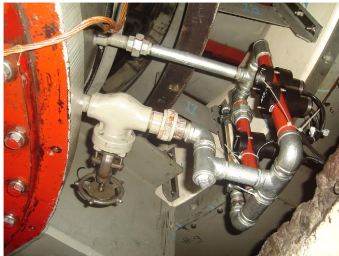
Figura 2.15. Sistema de Medición de Nivel de Aceite Cojinete Inferior Generador
