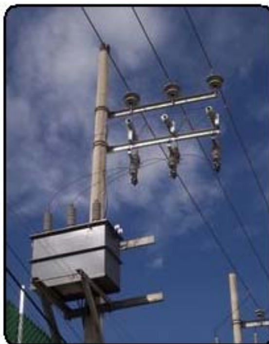
Figura 1.5: Transformador de Distribución
