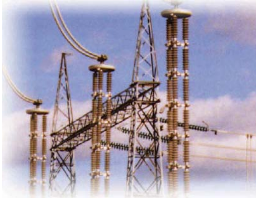
Figura 1.3: Subestación Eléctrica Elevadora.
