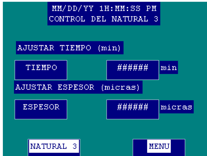
Fig. 2.39 Vista de la pantalla Control del Natural 3.
