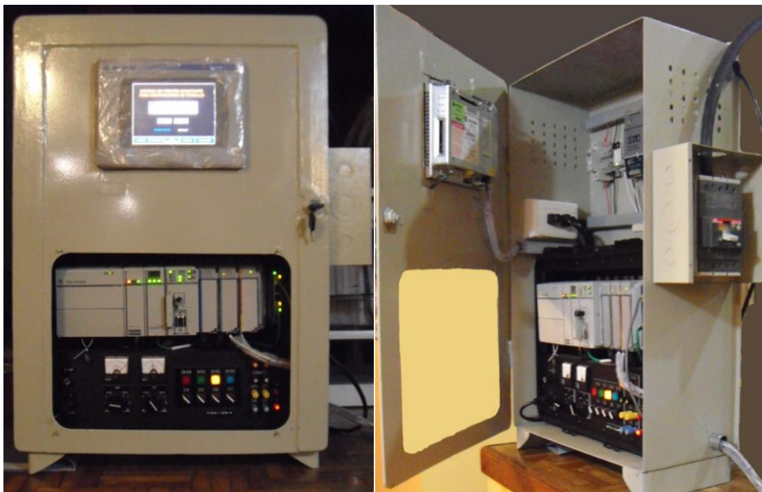
Figura 4.1. Tablero de control
