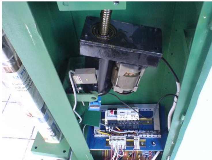
Figura 3.4 Vista interior de los componentes de fuerza
