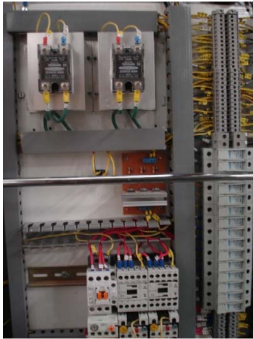
Figura 3.2 Vista interior de los dispositivos de control de la parte derecha
