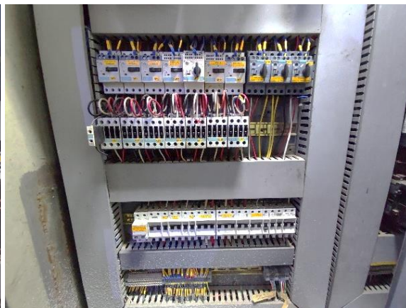
c) Protecciones eléctricas de motores
