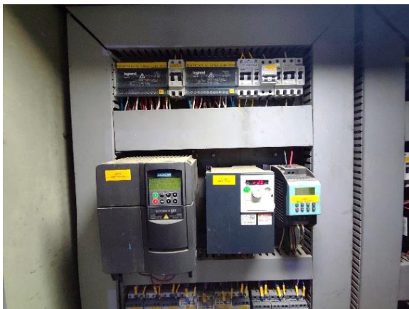
b) Variadores de frecuencia.
