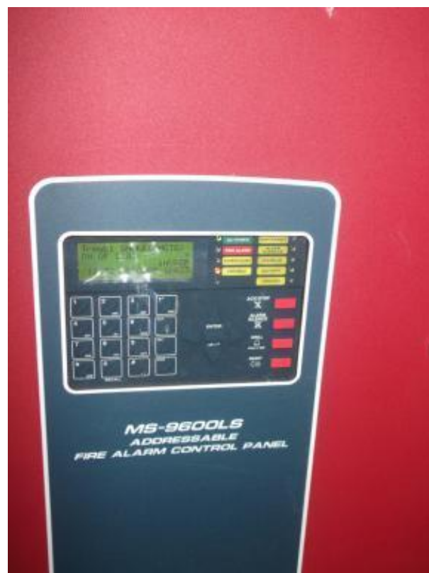
Figura 3.41 Panel de Control de alarma contra el fuego
