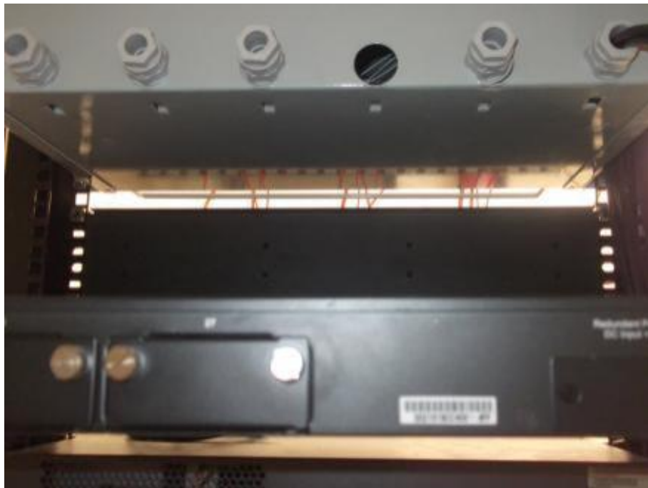
Figura 3.40 Vista posterior de los equipos
