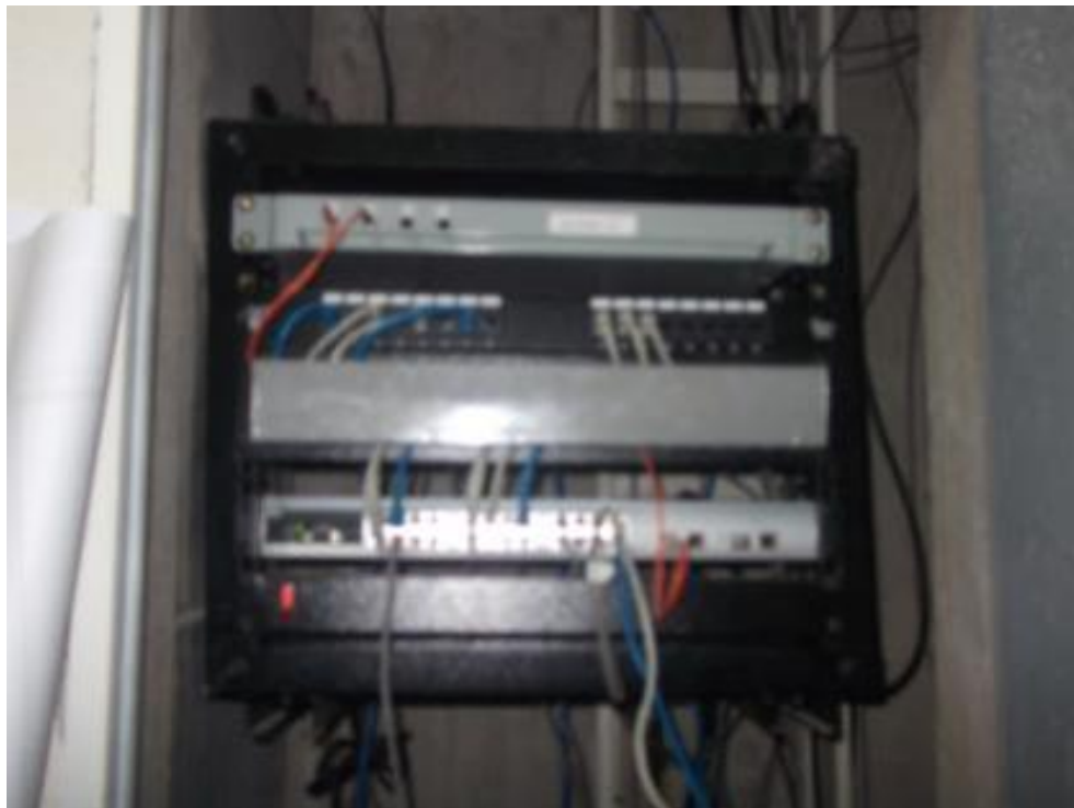
Figura 3.53 Equipos ubicados en cada uno de los pisos impares:
