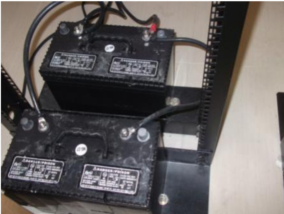
Figura 3.39 Vista de Respaldo de energía y baterías de los equipos
