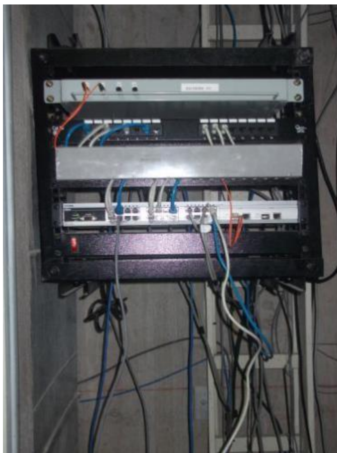
Figura 3.54 Vistas de los equipos ubicados en los tableros existentes en los pisos impares
