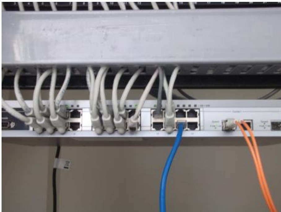
Figura 3.42 Vista frontal del Switch DES 3526 y conexiones
