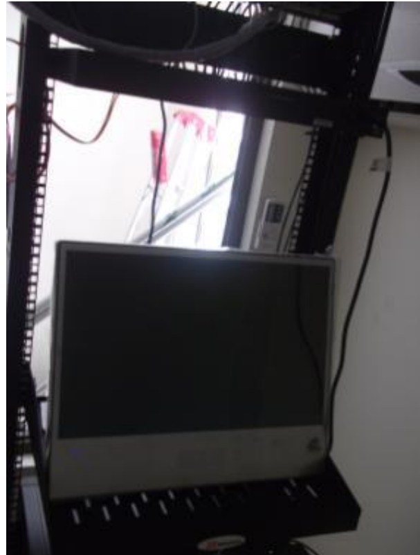
Figura 3.44 Vista frontal del ordenador para el sistema de programación ubicado en el cuarto de control
