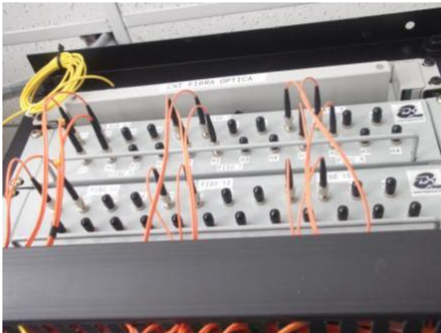
Figura 3.43 Vista de conexión de la Fibra Óptica
