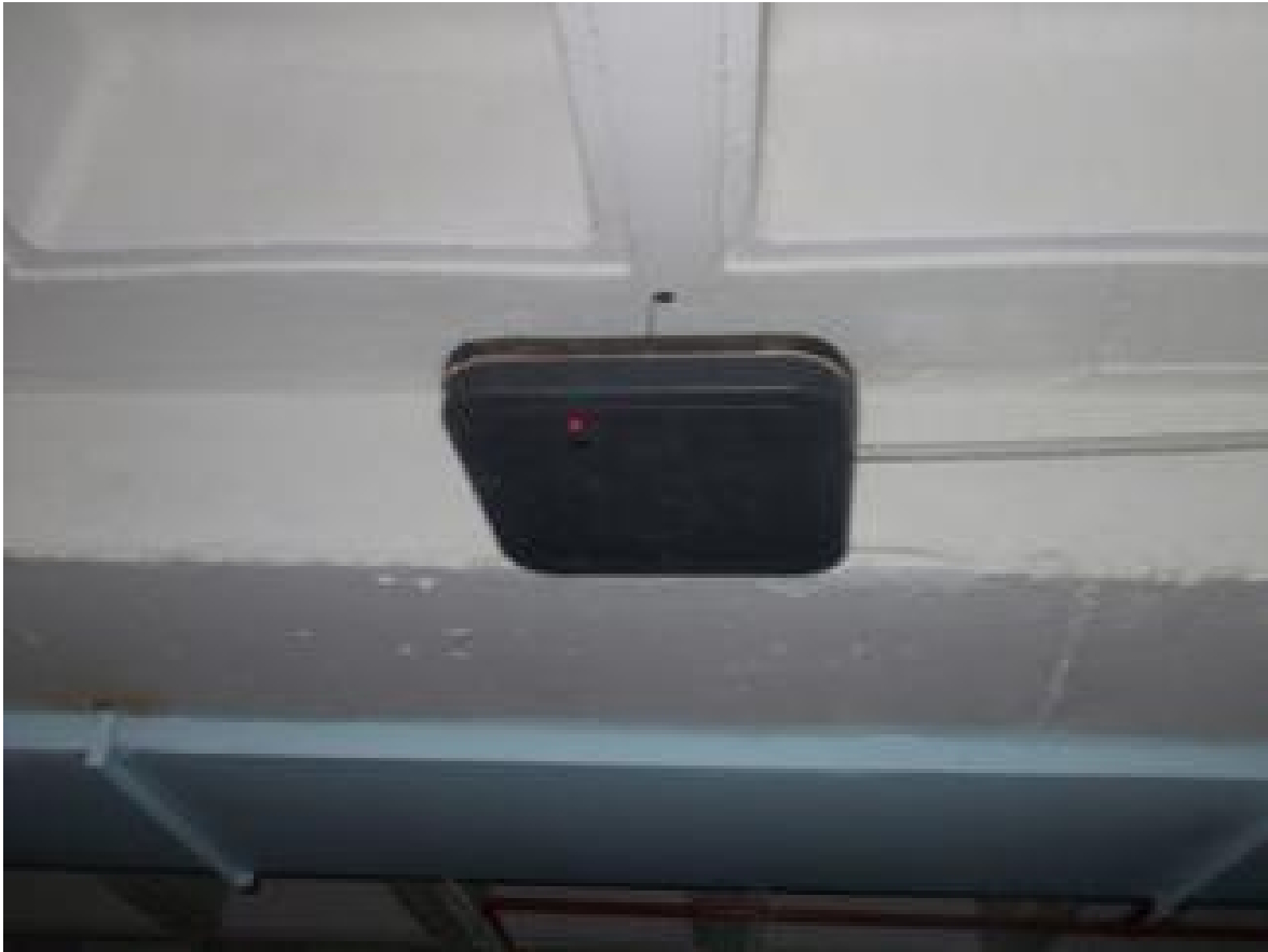
Figura 3.60 Cámaras y controles de acceso ubicados en los subsuelos
