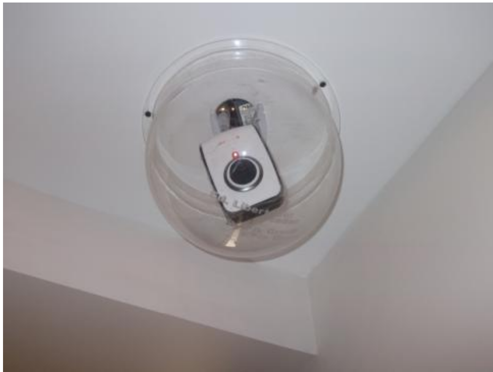
Figura 3.57 Cámaras ubicadas en los diferentes pisos
