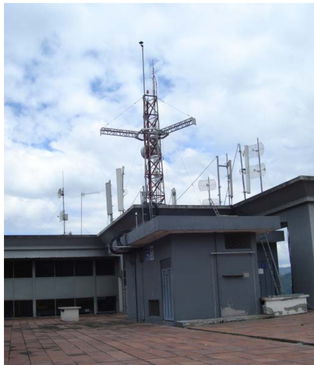
Figura.5.3. Infraestructura de Telecomunicaciones en el NOC
