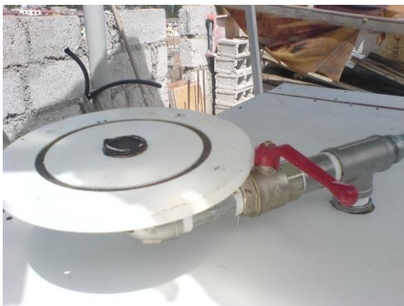
Fotografía 18: Soportes base del acumulador de liquido.
