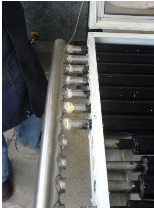
Fotografía 4: Distribuidor del adsorbedor/colector solar.
