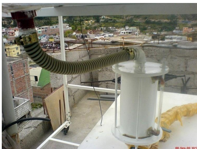
Fotografía 19 : Acumulador de liquido armado.
