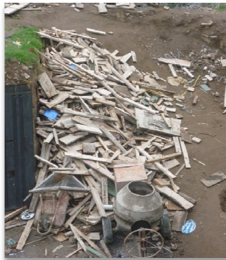
Foto 3-14: Desperdicio de encofrado en obra.
