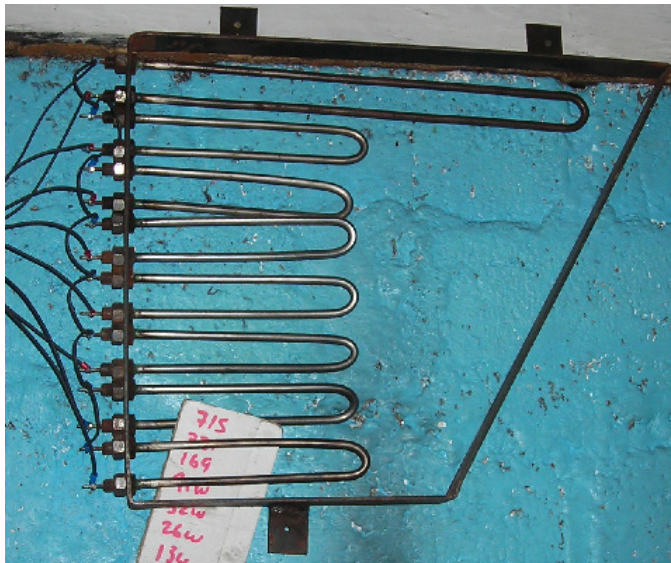
Banco de resistencias calefactores
