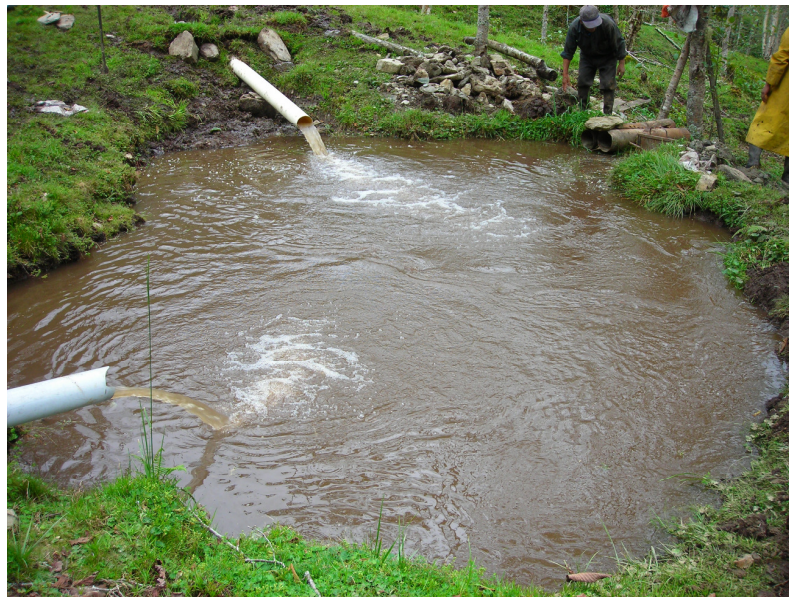
Fig. 5.3 Tanque de presión
