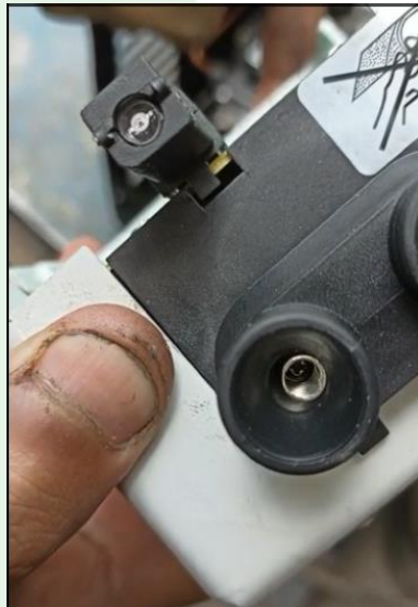
Instalación de la fotocelda en el quemador
