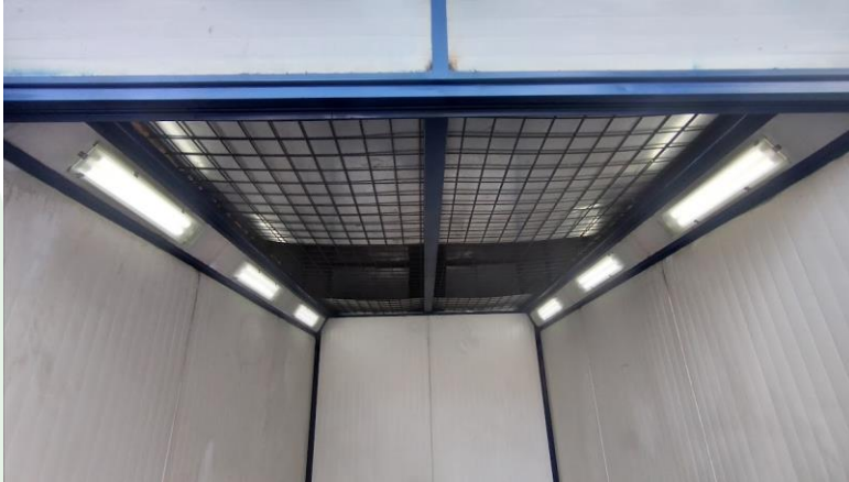
Iluminación al interior del horno de curado
