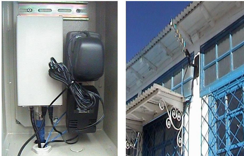
Figura 5.12 Radio FREEWAVE y Antena.
