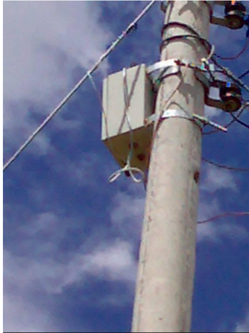
Figura 5.5 Antena y Radio repetidores
