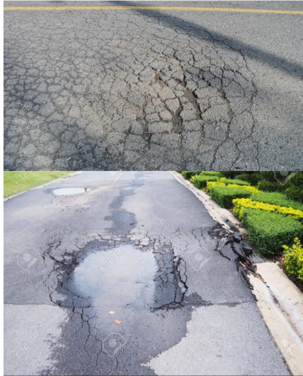
Daños en las carreteras
