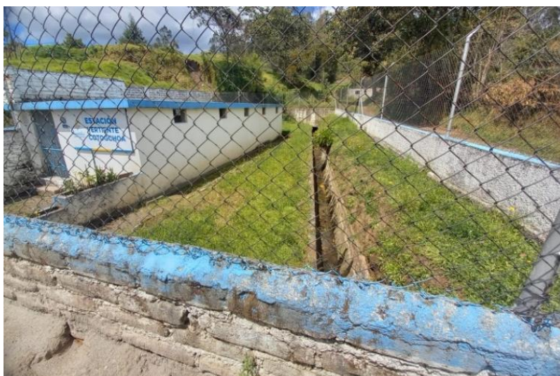
Captación de Cotogchoa
