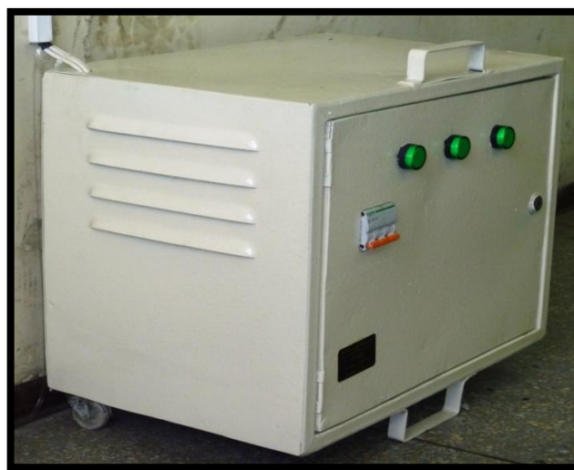
Figura 4.15 Filtro pasivo trifásico construido.
