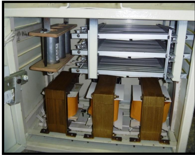
Figura 4.14 Elementos que constituyen el filtro trifásico.
