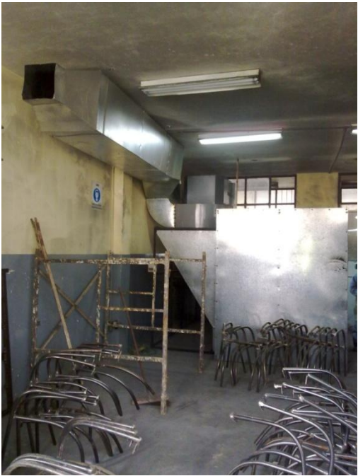
Figura 21 Ducto de salida completo
